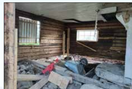
Gulvet i kjøkkenet var i dårlig forfatning. Foto: Ramstadåsen velforening
